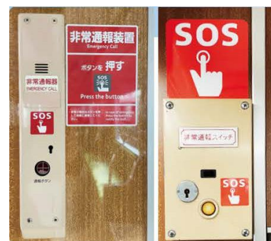
非常通報装置
