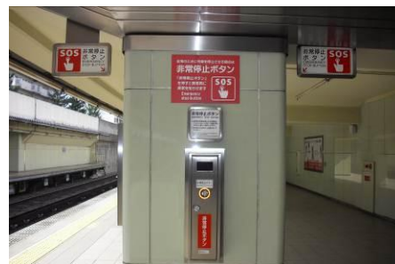
非常停止ボタン
